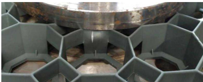
Rys. 3: Odkształcenia plastyczne/zniszczenie ożebrowania
